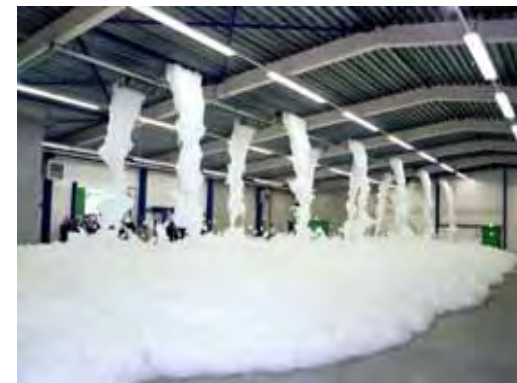
Impianto a schiuma
