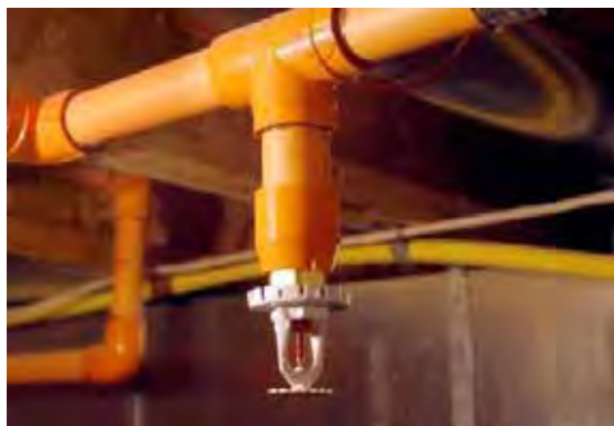
Impianto a pioggia (sprinkler)
